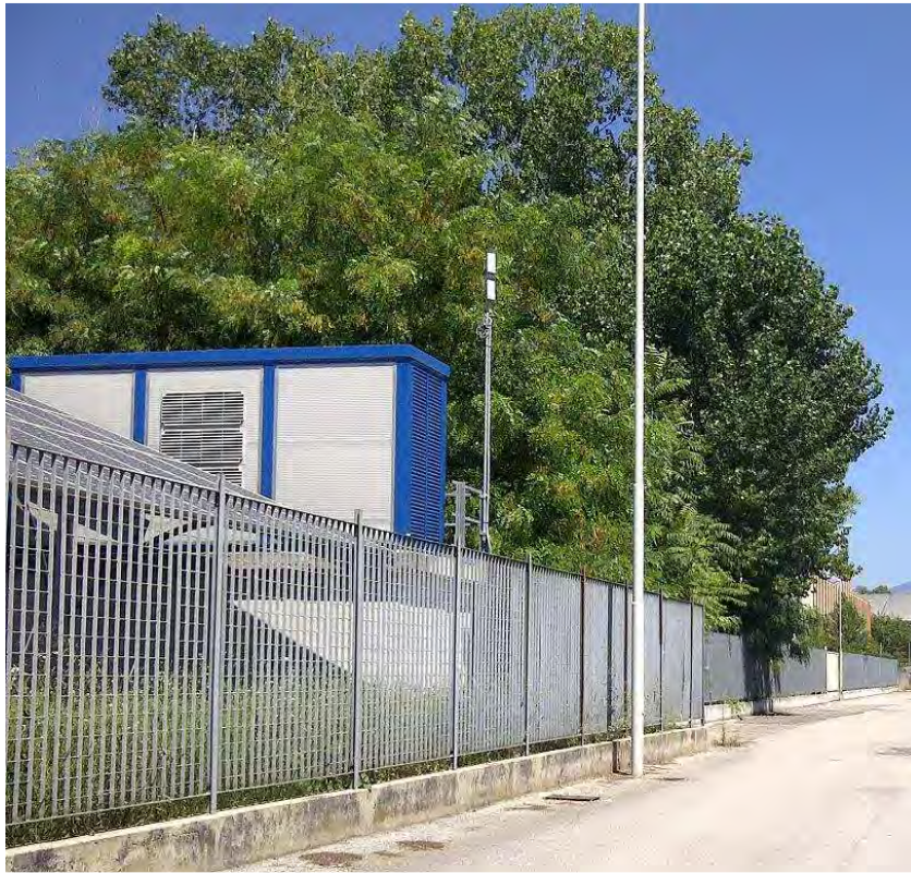
Figura 2.1-5 – Antenna del nuovo sistema di comunicazione installata presso l'impianto pilota numero 4
