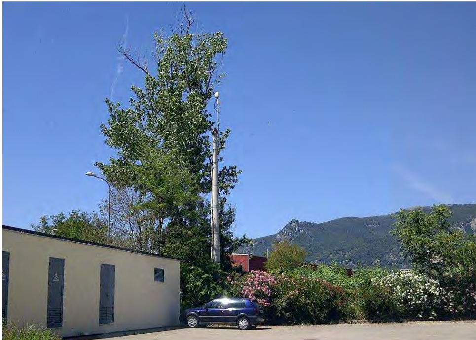
Figura 2.1-6 – Antenna del nuovo sistema di comunicazione installata presso l'impianto pilota numero 1
