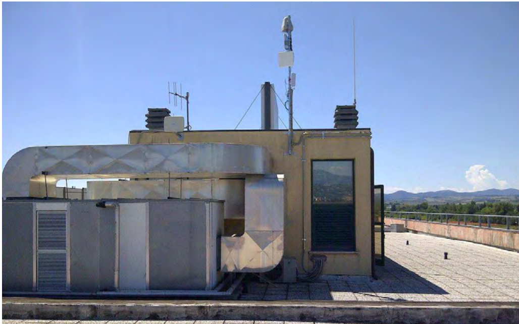
Figura 2.1-4 –Antenna del nuovo sistema di comunicazione installata presso la sede ASM
