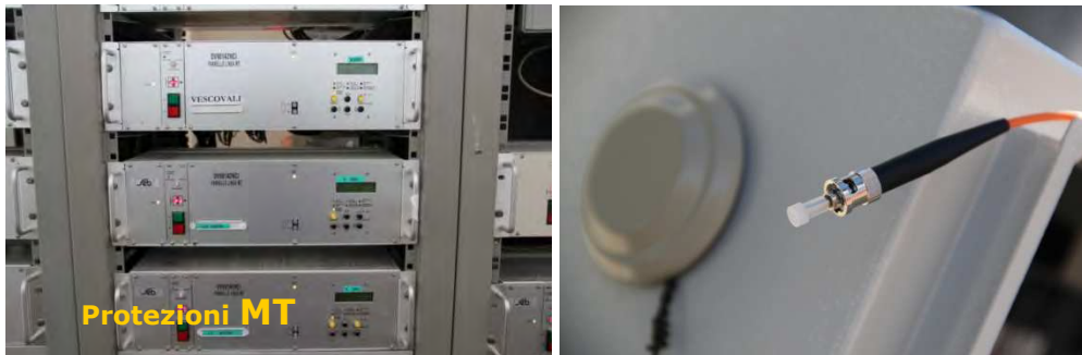
Figura 69: Particolari delle installazioni di sensori/moduli per la diagnostica in MT
