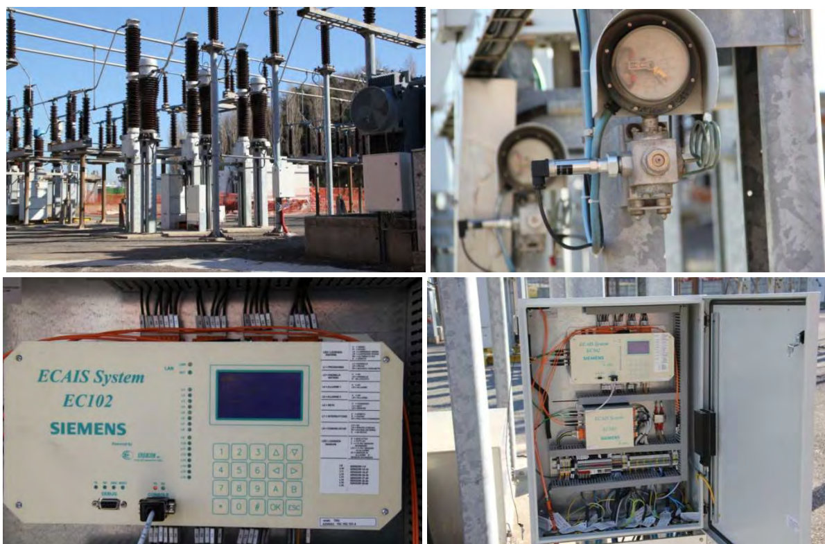
Figura 71: particolari di installazione sensori/moduli per la diagnostica di interruttori in AT
