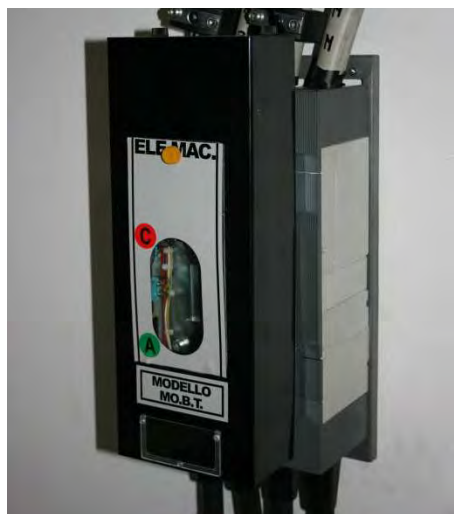
Figura 49: Foto di interruttore motorizzato installato in cabina secondaria
