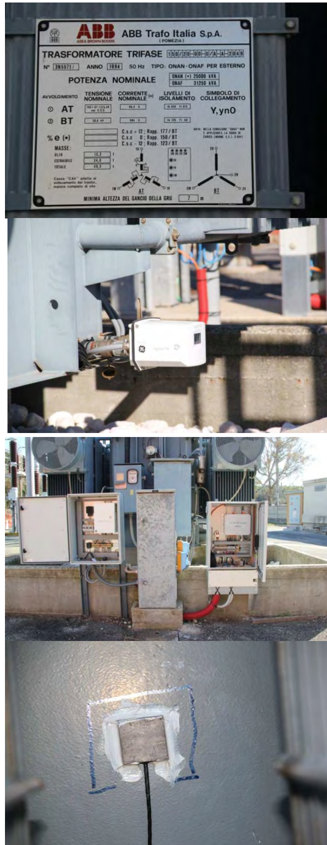
Figura 72: particolari di installazione sensori/moduli per la diagnostica di TR AT/MT
