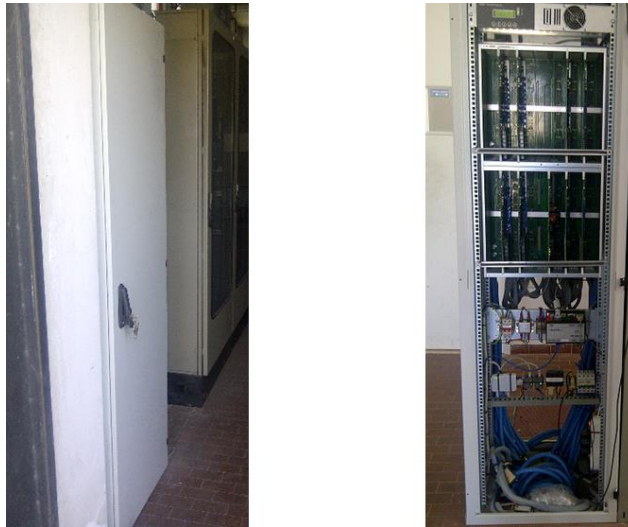
Figura 1.13 – Armadi RTU TPT2020 delle cabine di Ex Sit e Villa Valle
