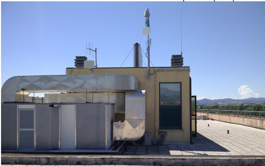
Figura 1.25 – Antenna del nuovo sistema di comunicazione installata presso la sede ASM
