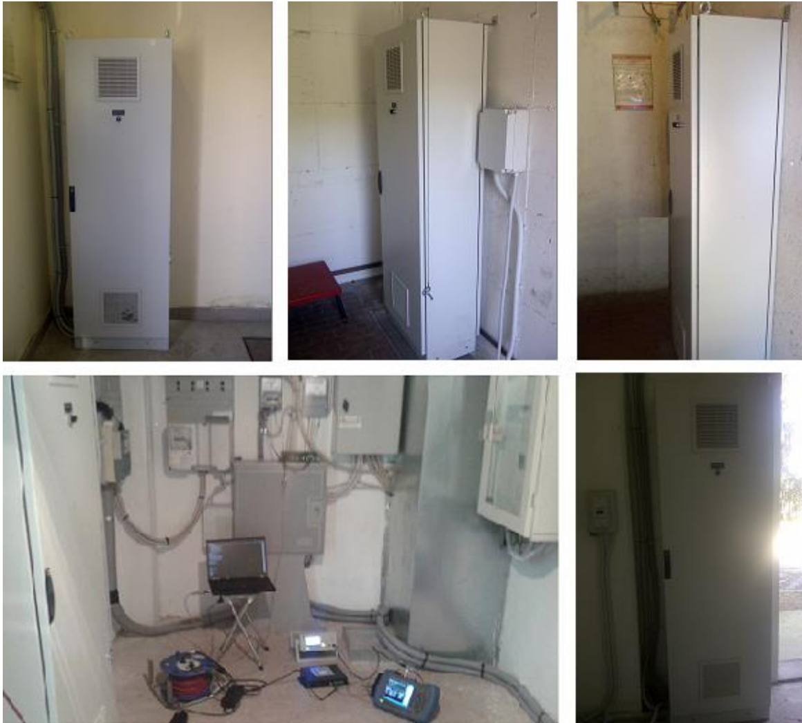
Figura 1.15 – Installazione degli apparati periferici nelle cabine degli impianti pilota
