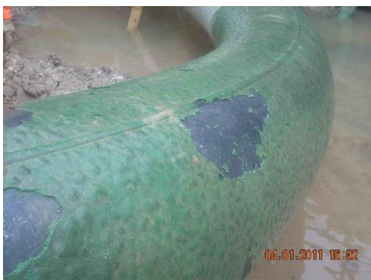
Fig. 3 Difetti nella protezione passiva
